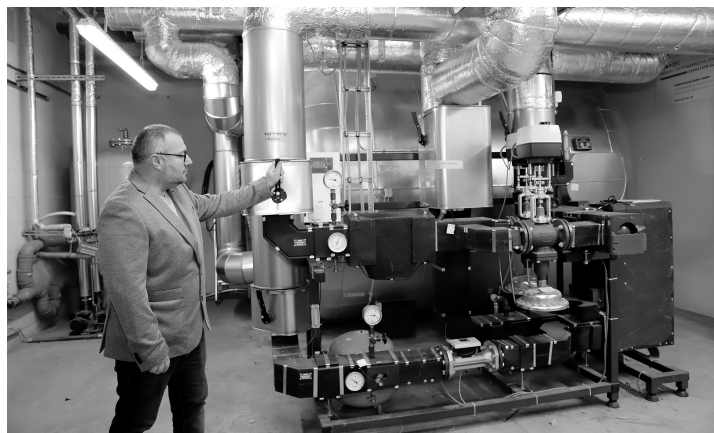
Martin Meier, Leiter der Gebäudewirtschaft, an der Übergabestation für die Fernwärme und Kälte im Keller des Landratsamts.
