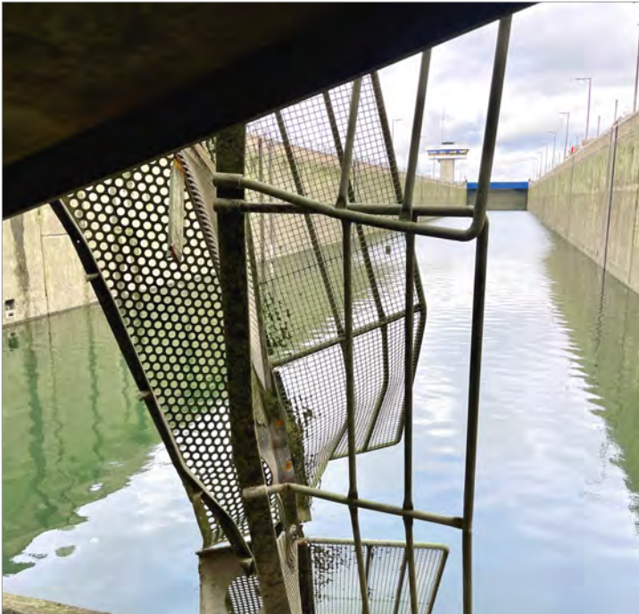
Beschädigtes Obertor mit Blick in die Schleusenammer
