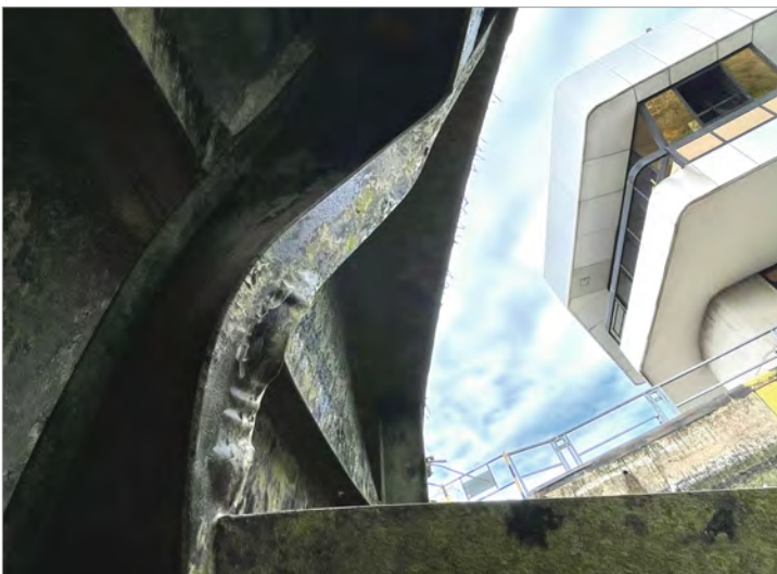
Prüfung des verbeulten Obertores
