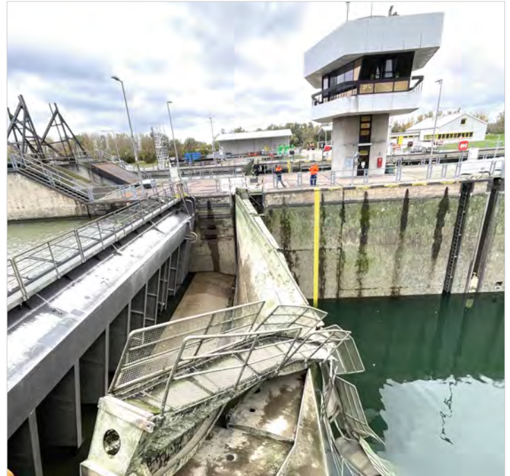
Beschädigtes Obertor mit Notverschluss
